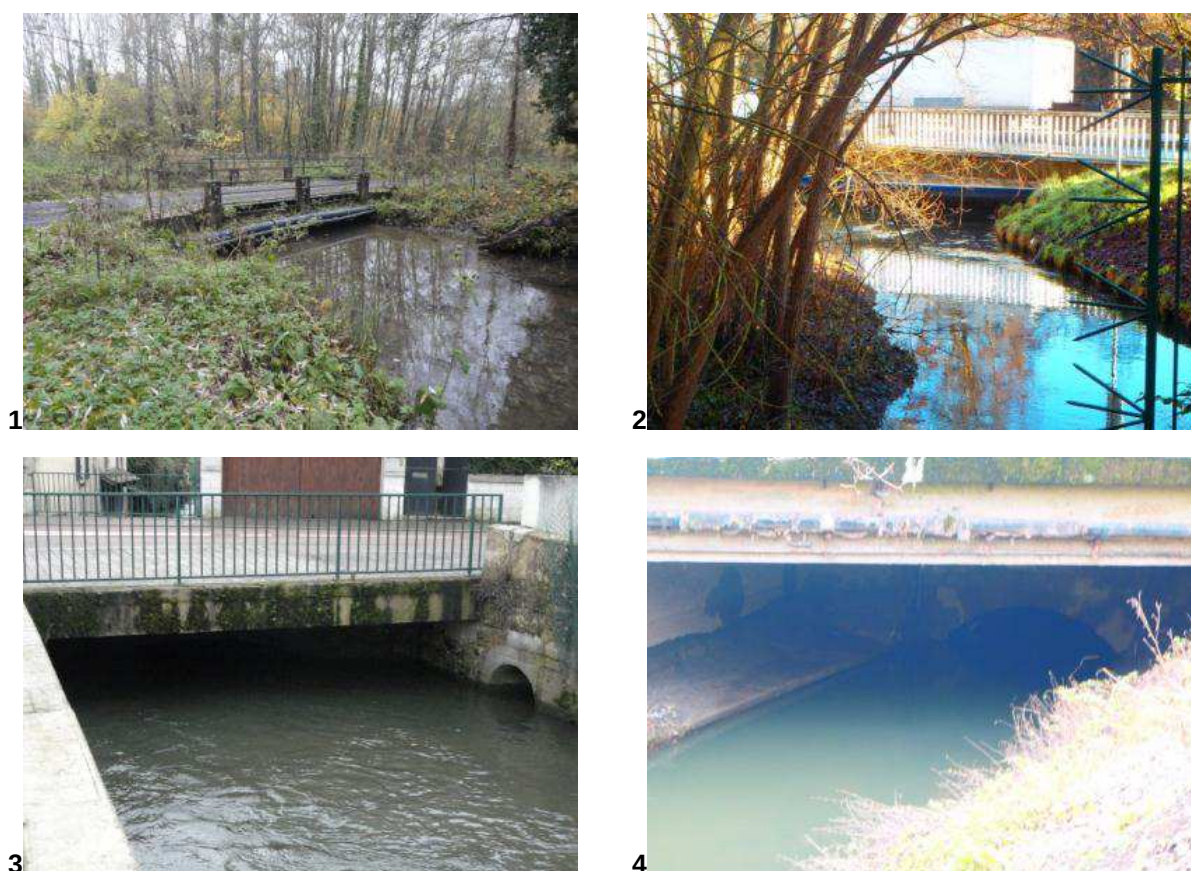
Figure 61 : Photographies de ponts sous-dimensionnés
