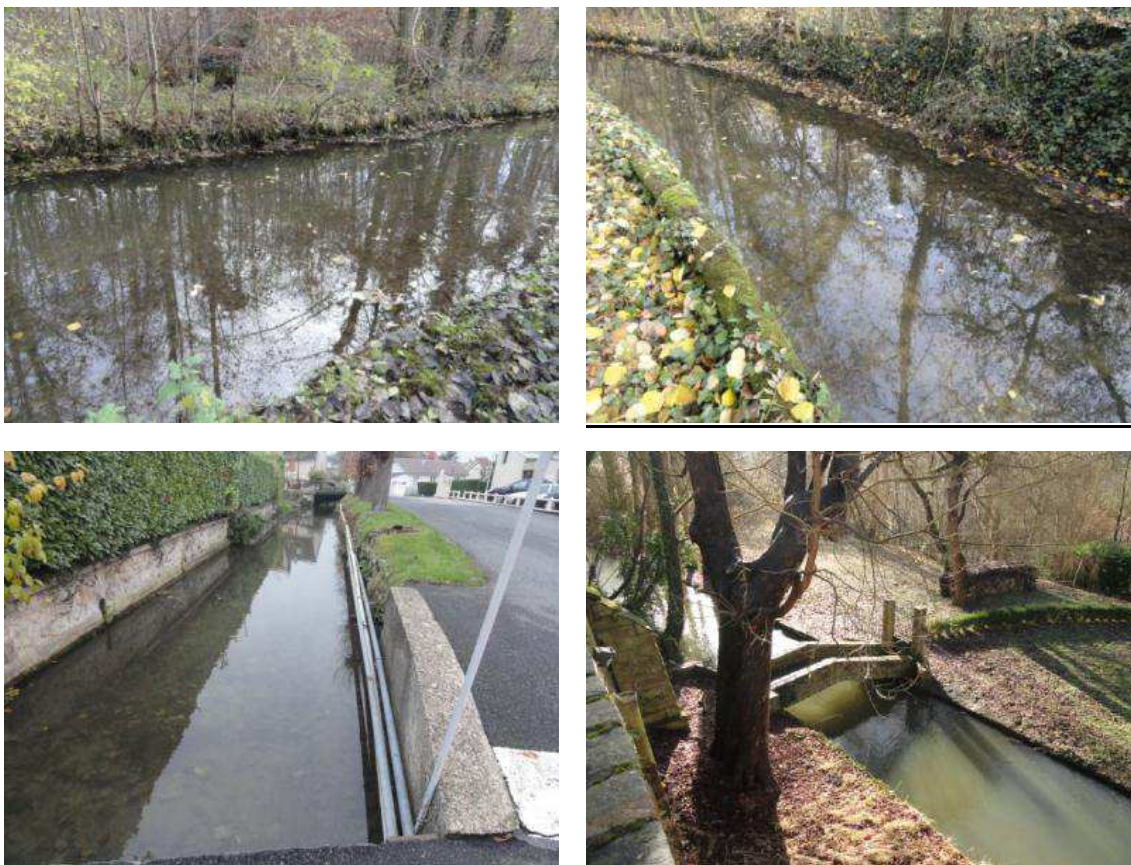
Figure 40 : Colmatage et absence d'écoulement sur des portions de cours d'eau recalibrées
